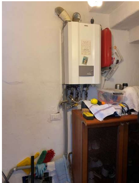
CALDAIA POSTA NEL SOTTOSCALA
